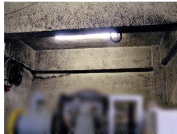
機械室吸音材
