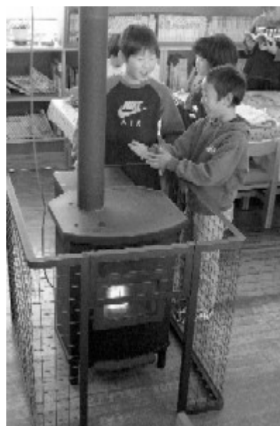
(e)小学校に設置されたペレットストーブ
