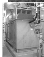
ガスエンジン式発電機80kW
