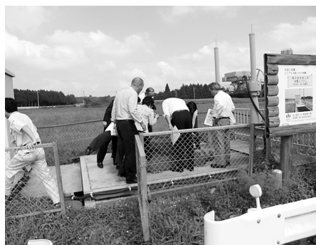
▲ 水路に設置された開水路落差工用発電システム（那須塩原市内）
