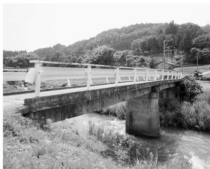
▲ 長寿命化が望まれる橋りょう(鹿熊地内)
