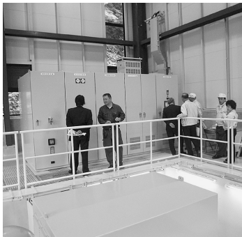
▲ 小早月川発電所
