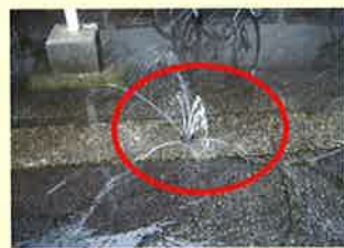
ノズルが破損した状態
