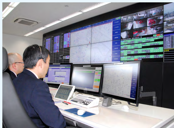
▲通信指令センターの様子。
