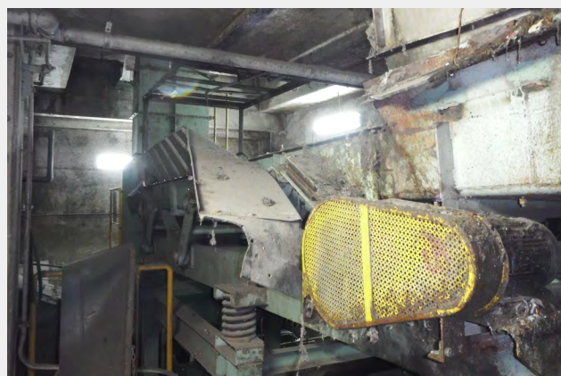
▲爆発事故により大きな被害を受けた振動コンベヤ
