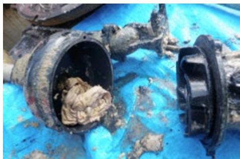
▲マンホールポンプの中に絡みついたタオル
