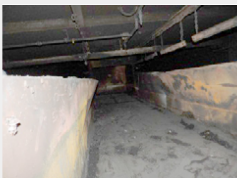
▲火災により黒く焦げた振動コンベヤ粉砕機
