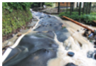
水害により変形した道路舗装(2014年(平成26))
