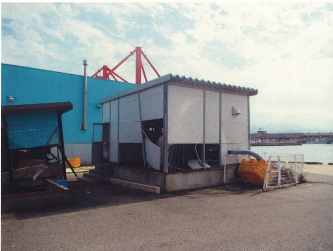
↑おさかなランド ポンプ小屋の一部損壊
