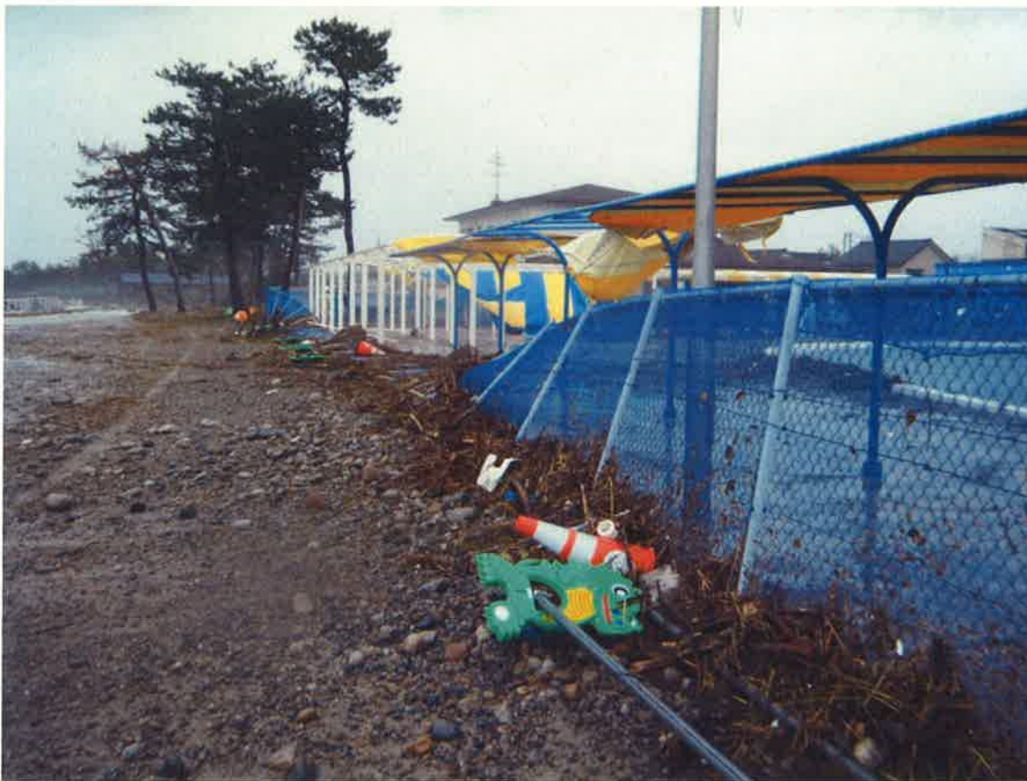
↑ミラージュランドプール内 海側フェンスの倒壊 (高 1.5m×約 60m)
