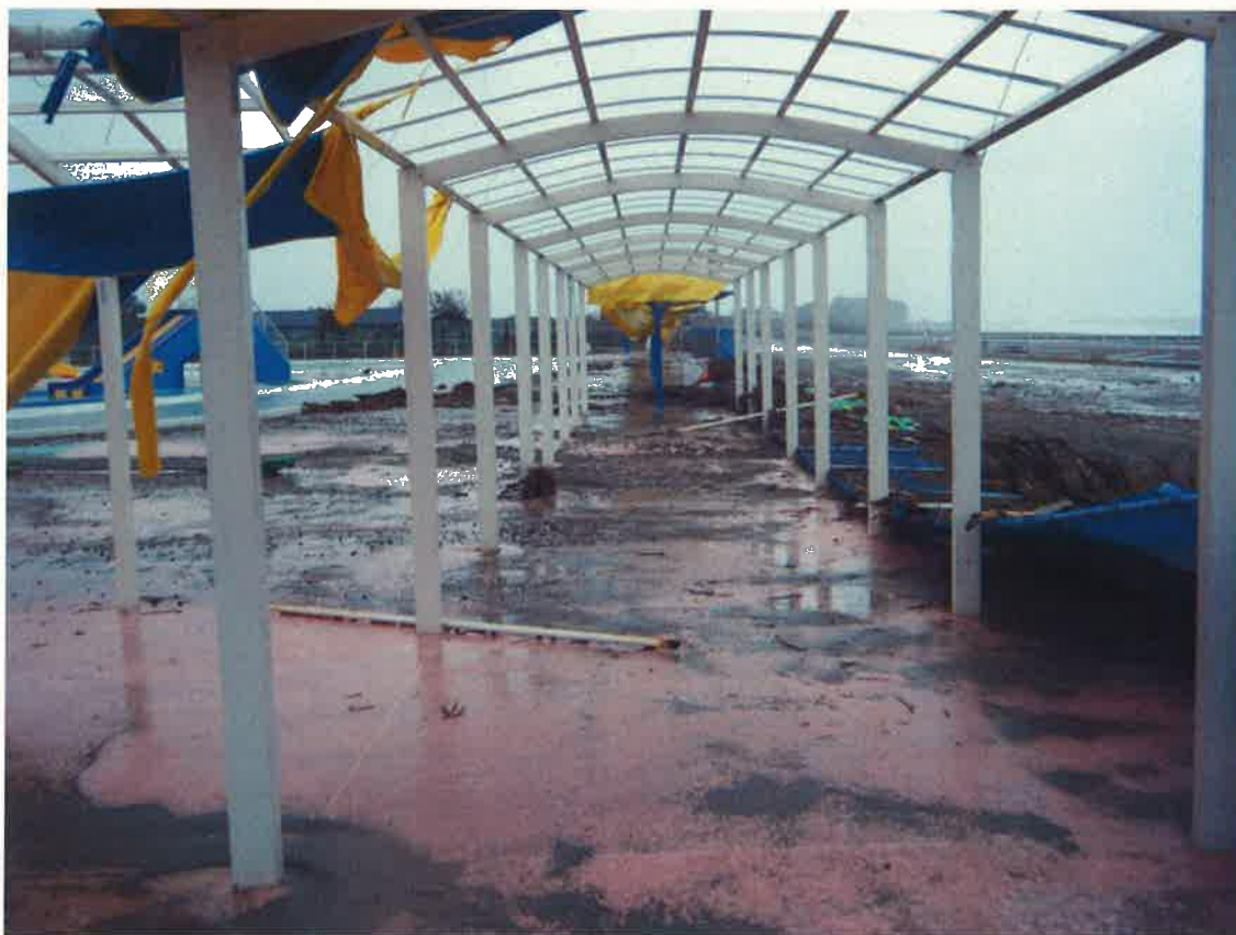
↑ミラージュランドプール内 テント屋根シートの破損 (幅 4m×約 110m)
