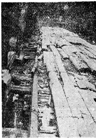
(写真は腐朽して通れない小坂橋)
