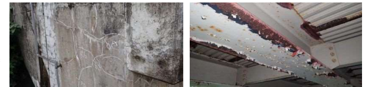
コンクリート橋のひび割れ
