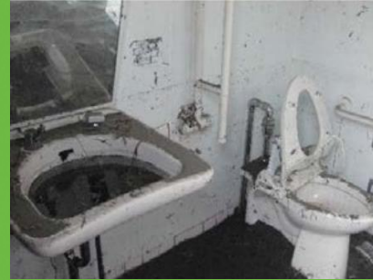
出典：日本トイレ研究所
