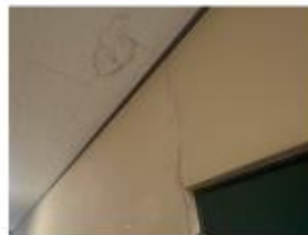
天井の水漏れと内壁のひび割れ
