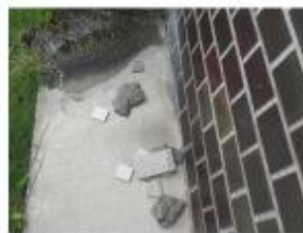
剥落した外壁タイル
