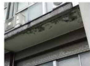
タイルと塗膜の剥がれ
