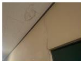
天井の水漏れと内壁のひび割れ
