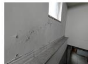
結露・乾燥による内壁塗膜の剥がれ
