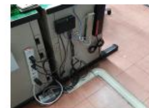
床の露出配線
