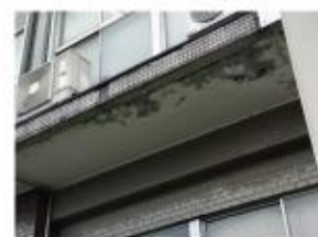
タイルと塗膜の剥がれ
