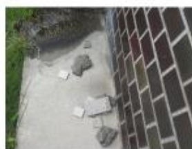
剥落した外壁タイル
