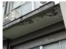
タイルと塗膜の剥がれ
