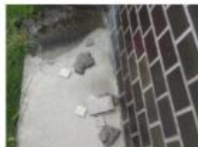
剥落した外壁タイル
