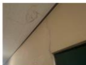
天井の水漏れと内壁のひび割れ
