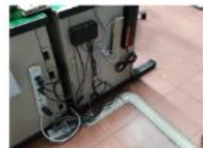
床の露出配線
