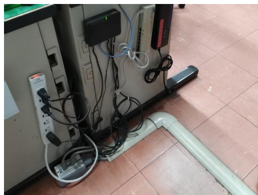
床の露出配線
