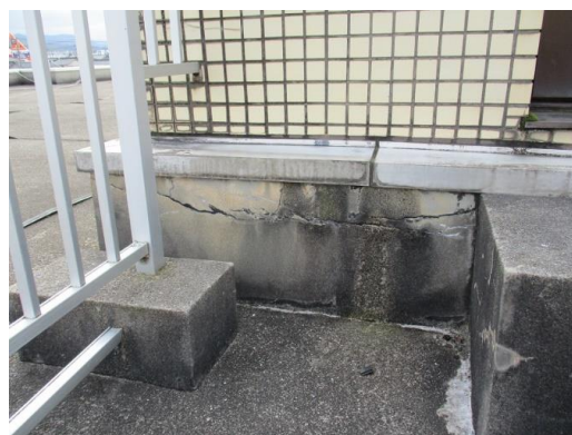
屋上のクラック
