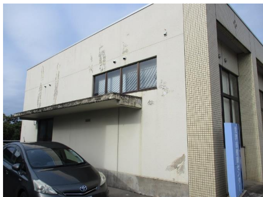
外壁の剥がれ
