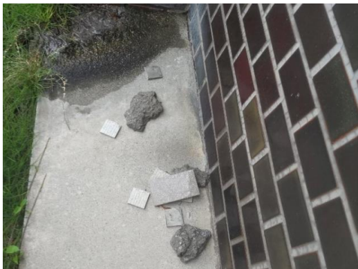
剥落した外壁タイル
