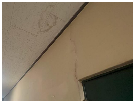
1階天井の水漏れと内壁のひび割れ
