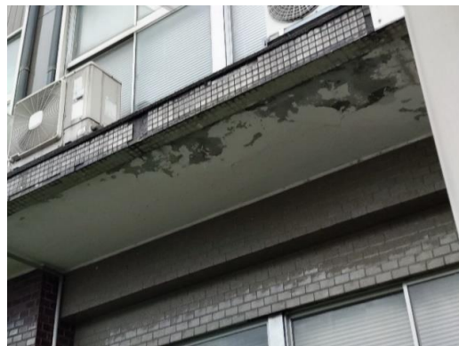
タイルと塗膜の剥がれ
