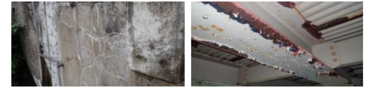
コンクリート橋のひび割れ
