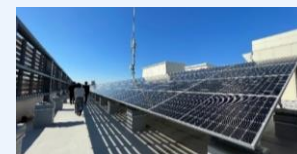
屋上に設置された太陽光発電設備 (下妻市役所)
