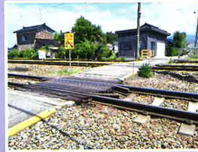
地鉄踏切内の木製段差緩衝材が傷んで いる。児童・生徒がつまづくことがある。
