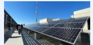
屋上に設置された太陽光 発電設備 (下妻市役所)
