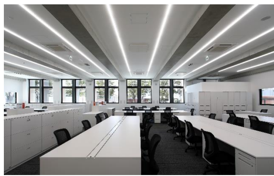
LED照明（たつの市役所）
