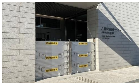
出入口に設置された防水板 (出典：八潮市HP)
