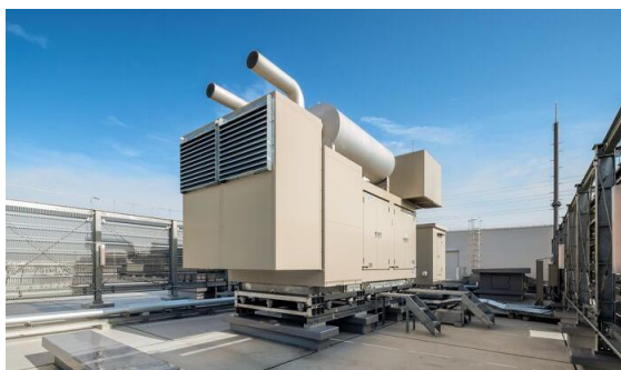
屋上に設置された非常用発電機 (出典：八潮市HP)
