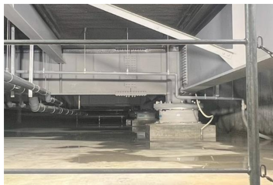
免震装置（伊丹市役所） 基礎と建物の間に設置し、地震のエネルギーを吸収して建物に揺れを伝えないようにする装置。
