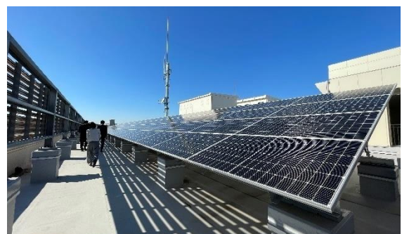
屋上に設置された太陽光発電設備 (下妻市役所)
