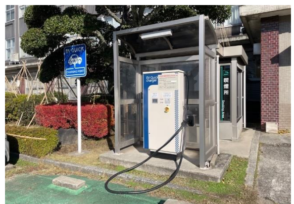
本庁舎駐車場に設置されているEV充電設備
