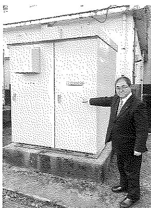
更新が必要な経田小学校の変電施設
