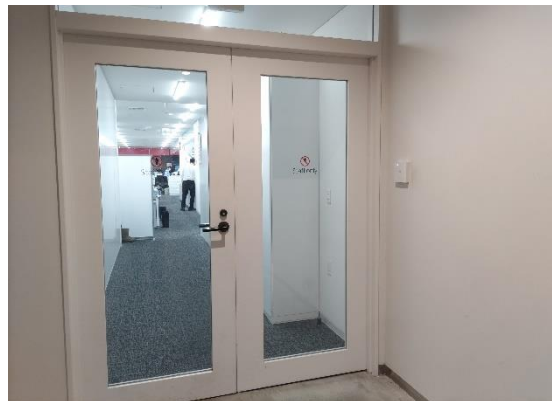
電気錠による区画（旭市役所）
