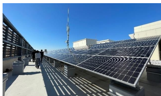
屋上に設置された太陽光発電設備 (下妻市役所)
