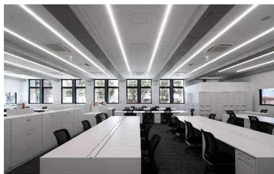
LED照明（たつの市役所）
