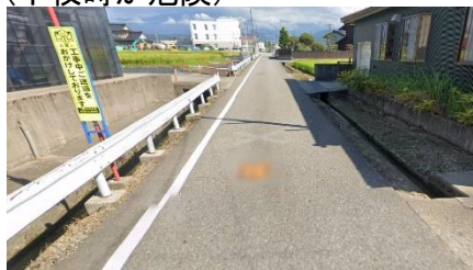
⑥水路側路肩の盛土が流失し、ガードレール下から転落の恐れあり(下校時が危険)
