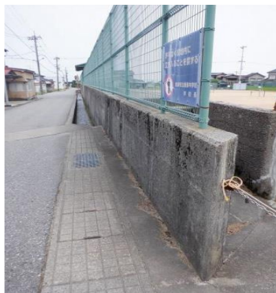
②道幅が狭い。テニスコート横の側溝の蓋や縁石が途中までしかない
